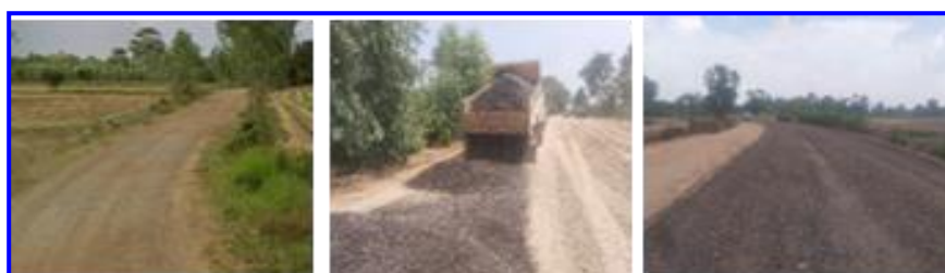
โครงการขยายถนนดินลงหินคลุกหนองประทาน หมู่ที่ ๕ บ้านสะเดา
